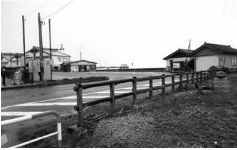
老朽化した擬木柵
