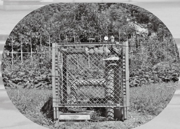
安定した飲み水の確保(大釜谷地内)
