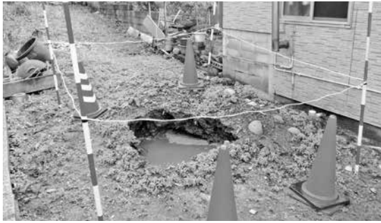
尼瀬の油井戸陥没現場
