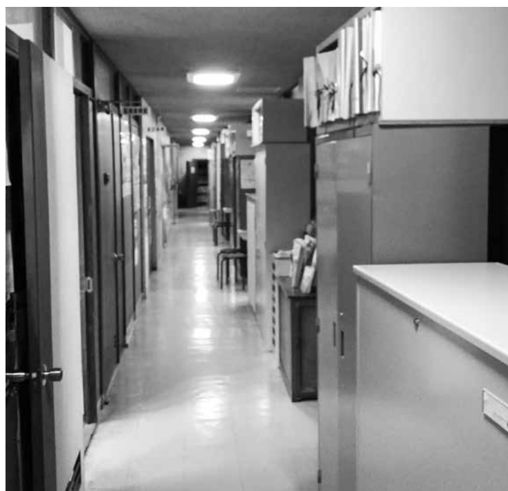
人が行き交うことも困難な2階廊下の状態
